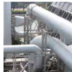
ダクトワーク Duct work
